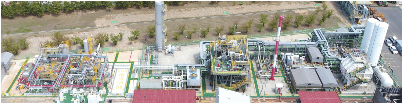
그림 2 삼성중공업 거제조선소 친환경 (LNG 및 암모니아) 실증설비
